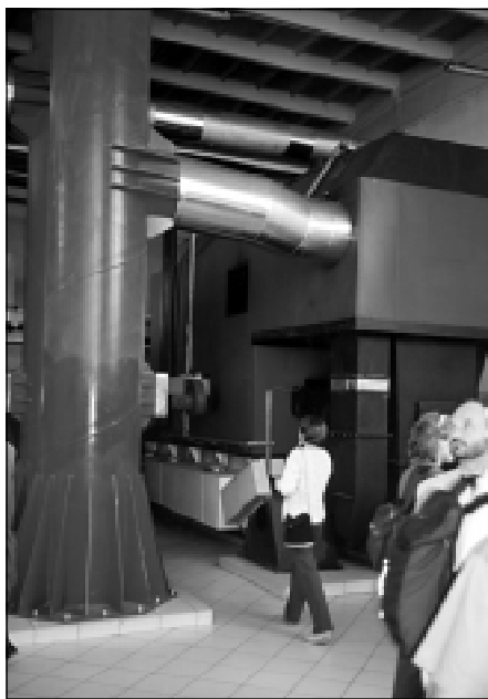
Kocioł o mocy 2 MW w kotłowni opalanej drewnem w Kępicach (woj. pomorskie).
