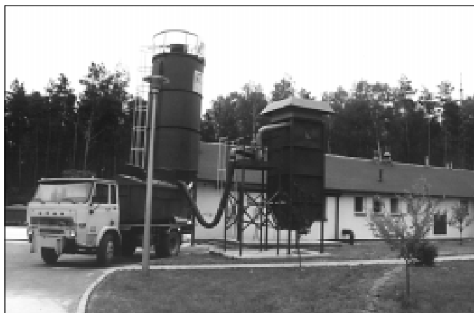
Instalacja do przerobu osadów.
